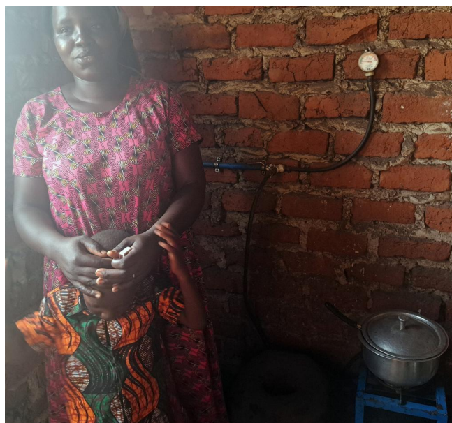
Offenes Feuer ist dank der Biogasversorgung nicht mehr zum Kochen nötig. © Caritas
